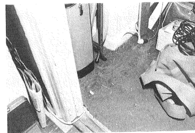
Figur 34. Den anden ledning (galnsgarnsledning) fra tristikdåsen (figur 32) var afsluttet i en ældre type forlængerled, der lå løst på gulv, og hvortil der var sluttet en tilledning til et køleskab i køkkenet. Tilledningen til køleskabet var fremført under gulvtæppet i pulterrummet og ført gennem døråbningen til køkkenet. - Afsnit 6, pgf. 26.2.4 og 26.2.6.
