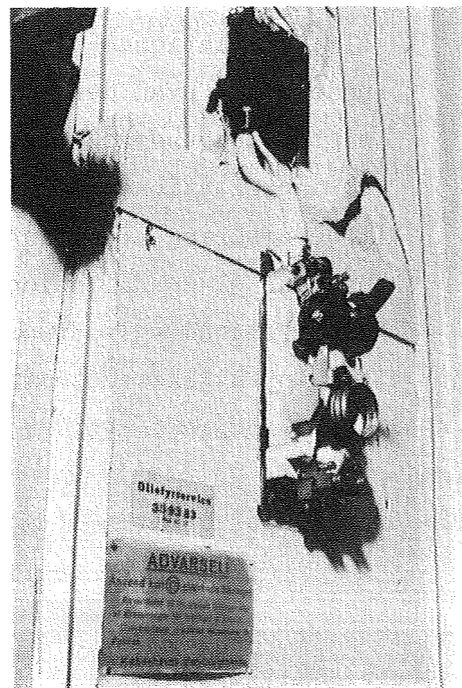
Figur 25. I stålrørdsåsen umiddelbart over gruppetavlen var tilsluttet en tilledning til et tyverialarmanlæg, placeret på væggen under gruppetavlen, (se figur 3). Der var ikke installeret en afbryder i den faste installation foran tyverialarmanlægget. - Afsnit 6, pgf. 30.2.1. Kontaktstederne for tilledningen var ikke aflastet for træk og sikret mod vridning i rørdåsen. - Afsnit 6, pgf. 26.2.5. Tilledningen og et plastinstallationskabel var indført gennem samme studs i rørdåsen. - Afsnit 6, pgf. 27.4.1.
